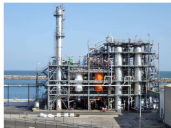
Unité de production de biodiesel de Diester Industrie, à Sète (Hérault), sur technologie Esterfip-H* d'Axens
